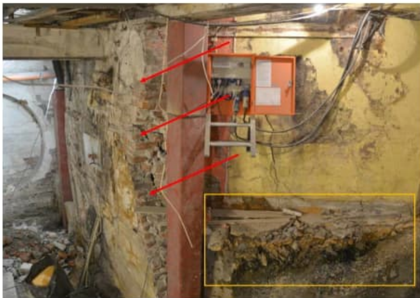
Figur 3 Eksempel på skader på bygningskonstruksjoner som følge av forvitring av alunskifer. Vegg presses ut pga. svelletrykk fra forvitrende alunskifer (røde piler). Vegg er fundamentert direkte på og etablert inn mot alunskifer og står i fare for å rase ut pga. setninger. Foto: Erik Endre
